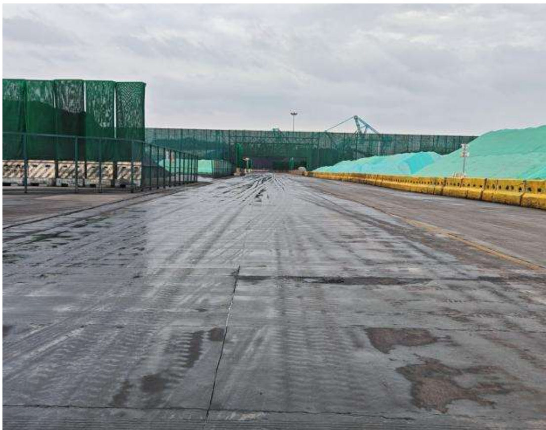
图 4.1-11 横三路道路现状图（局部破损）
