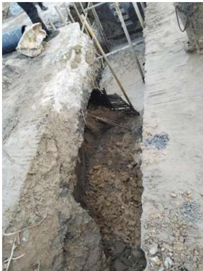
图 4.1-12 面层结构下脱空现场图
